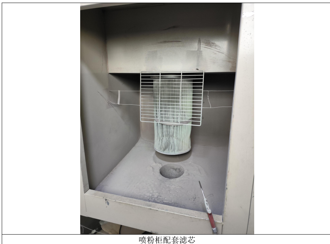
图 4.1-7 无组织废气治理设施现场照片
