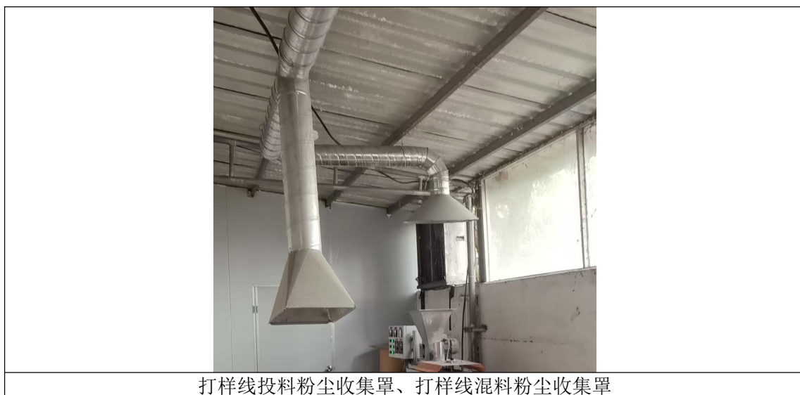
图 4.1-3 粉尘废气治理设施现场照片
