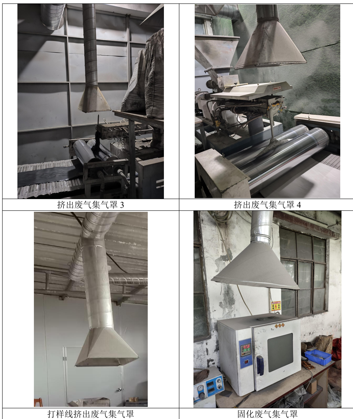
图 4.1-5 有机废气治理设施现场照片
