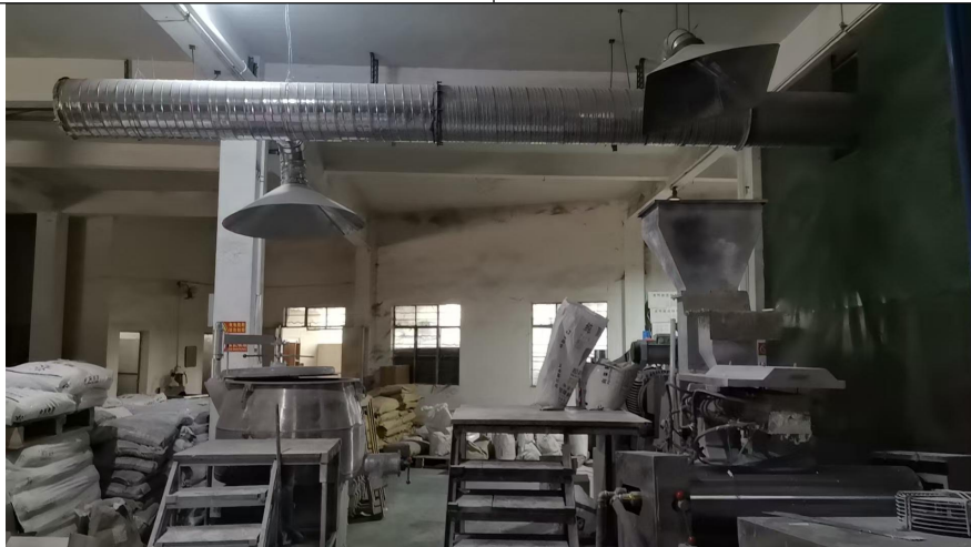
投料粉尘收集罩 4、混料粉尘收集罩 4
