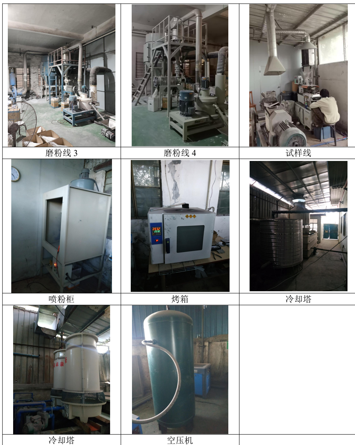
图 3.2-2 主要设备现场照片
