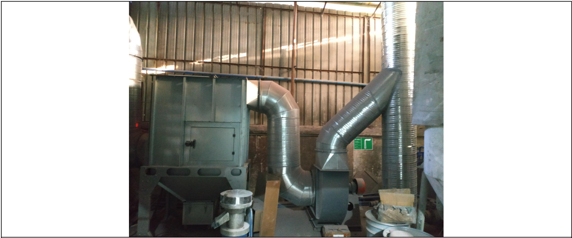
布袋除尘器及排气筒 DA001
